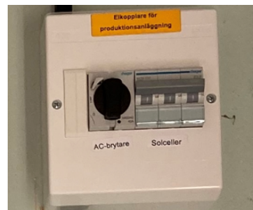
Ovan: Säkringar & elkopplare
