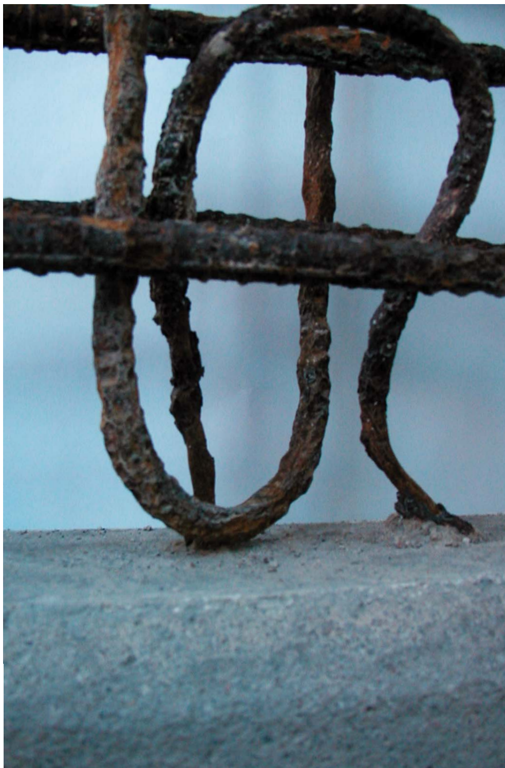
Armeringsjärnen i många av föreningens balkonger var i mycket dåligt skick.
