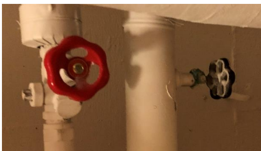
Bilden visar ventilar i källargång
