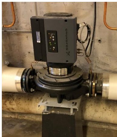
Bilden visar cirkulationspump för värmepump
