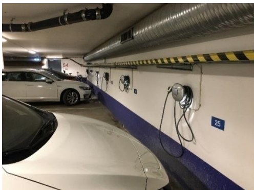
Laddplatser i parkeringsgaraget
